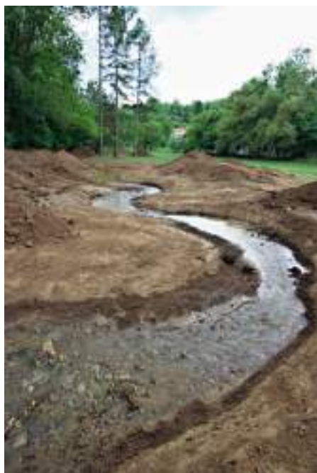
NOVÉ KORYTO NA MÍSTĚ VÁNOČNÍHO BETLÉMU.
